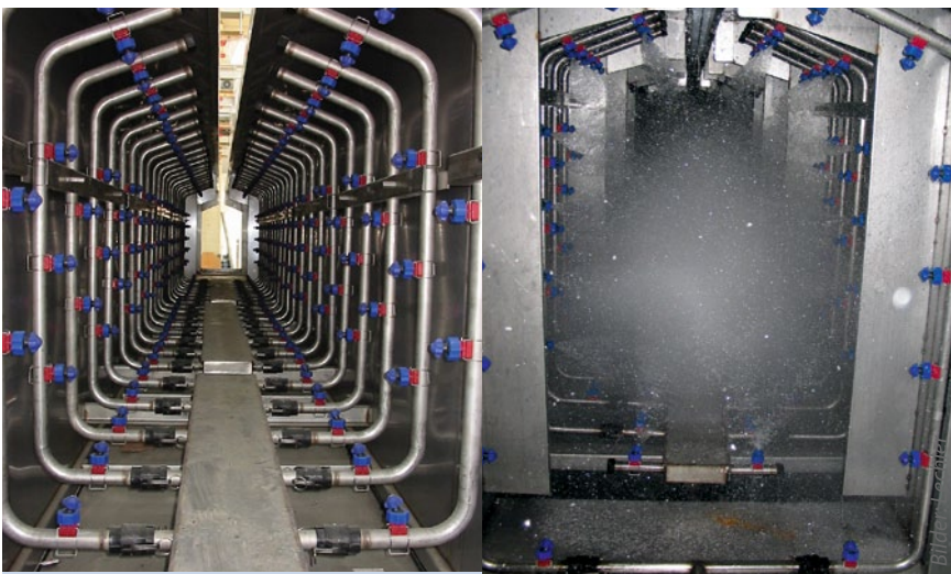
Bild 3: Spülzone am Ende einer Lackierstraße
